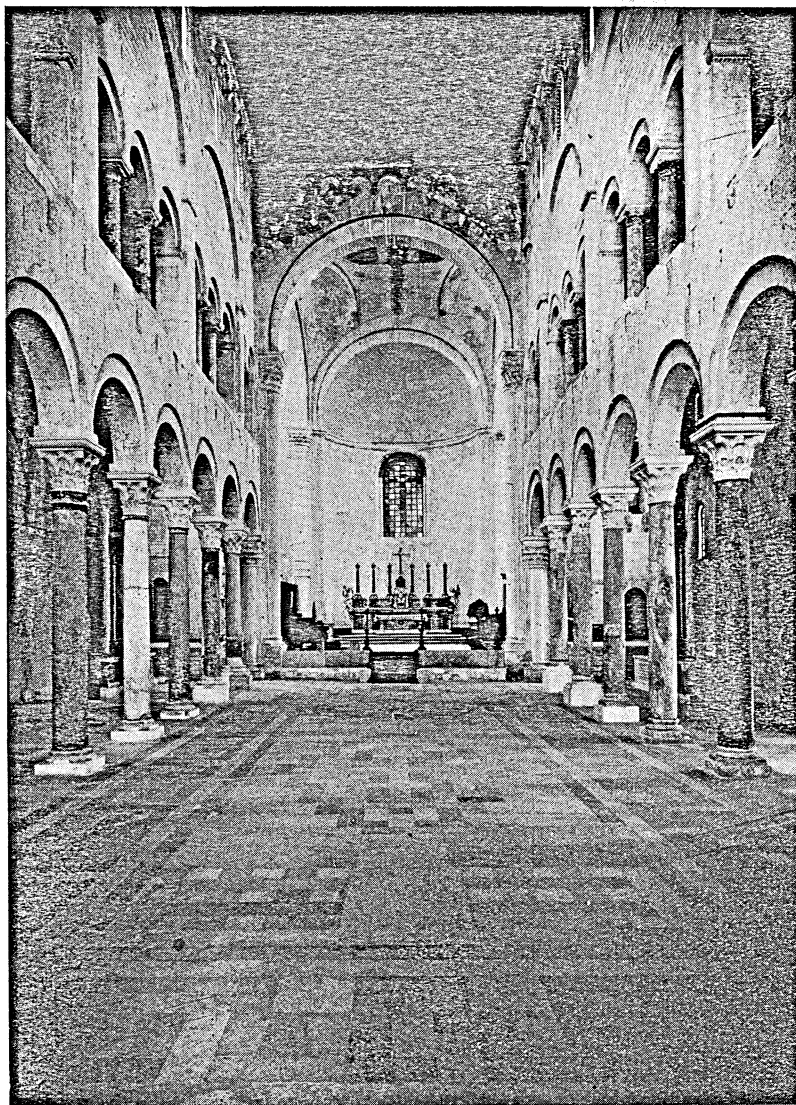
Fig. 1 — Interno della cattedrale dopo il restauro. Sono visibili al di sotto del piano del triforio le radici spezzate dalle antiche mensole dei ballatoi.
